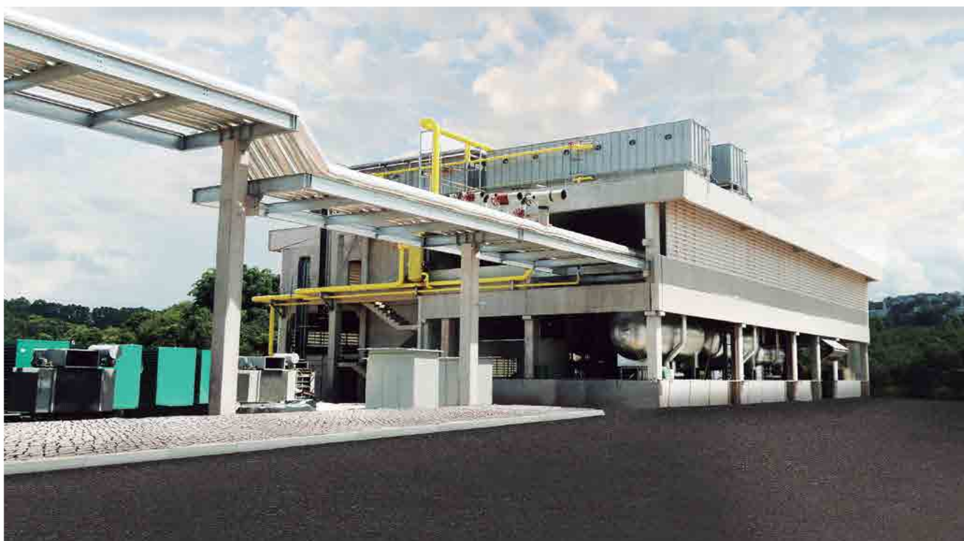
Sala de Máquinas em NH 3 Sala de Máquinas en NH 3
