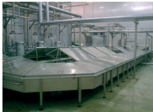
MONTAGEM DE LINHA PARA PROCESSAMENTO DE QUEIJO / CHESSE PROCESSING
